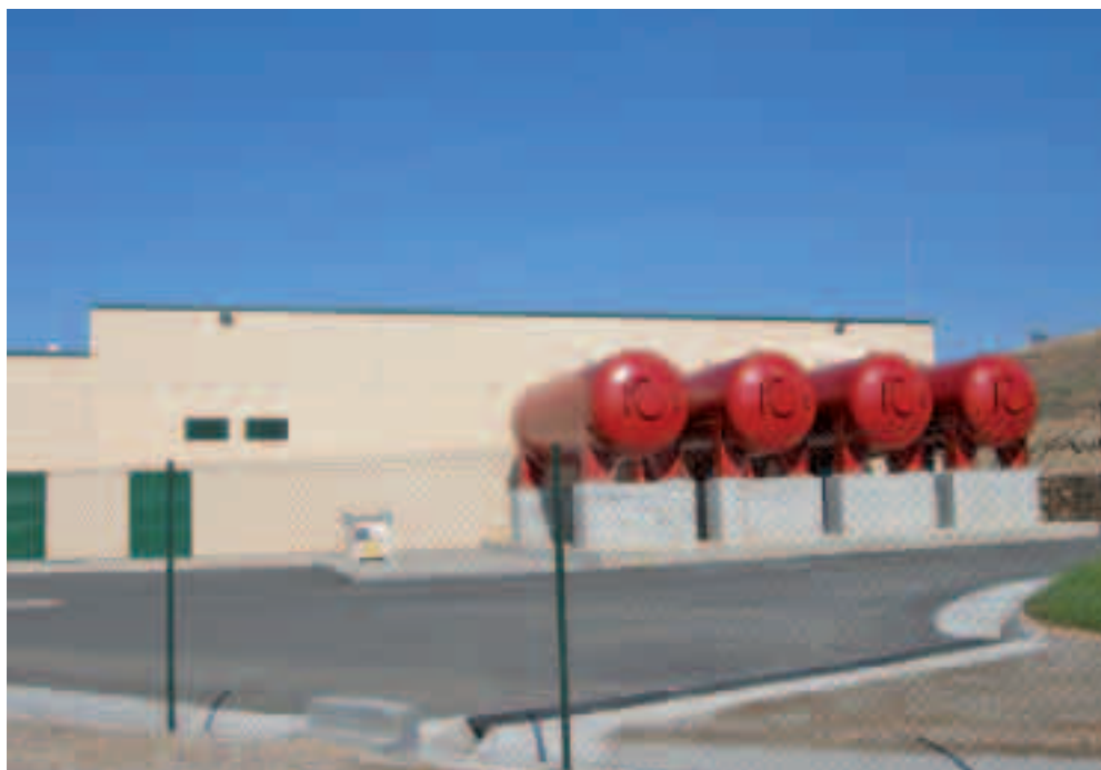
Estació de bombeig a la bassa de Mas Roig.
