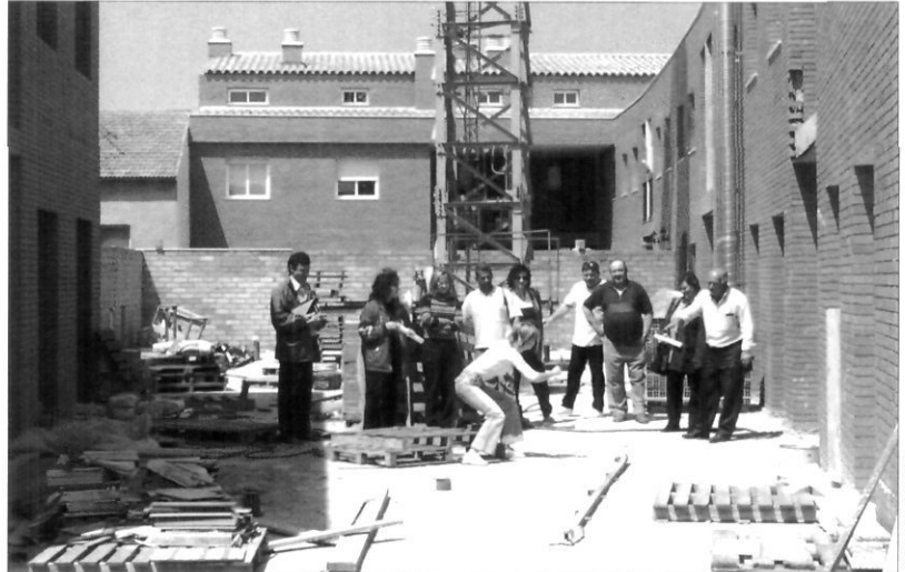
Un grup de veïns afectats a l'interior del bloc.
