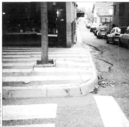
L'Avçda. Àngel Guimerà està en un estat defectuós. Ja va sent hora que s'arrangi.
