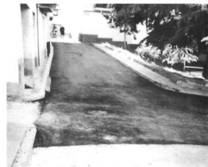
L'encimentat dels carrers Castell i Ntra. Sra. de la Mercè mostrava un millor aspecte abans que no pas amb l'actual capa d'asfalt. S'ha consultat als tècnics per fer aquesta actuació tan criticada?
