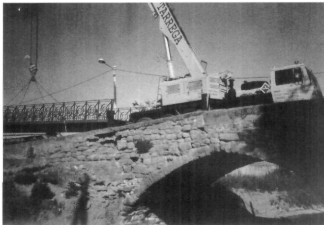
Durant la instal·lació caigueren pedres del pont.
