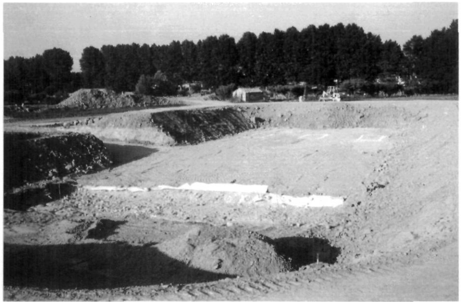
Un dels dipòsits de la depuradora.
