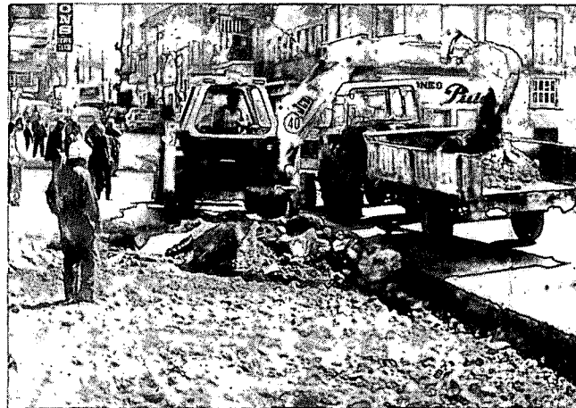
S'estan duent a terme les obres d'acondiament de voreres a l'Avgda. M. Jolonch.
