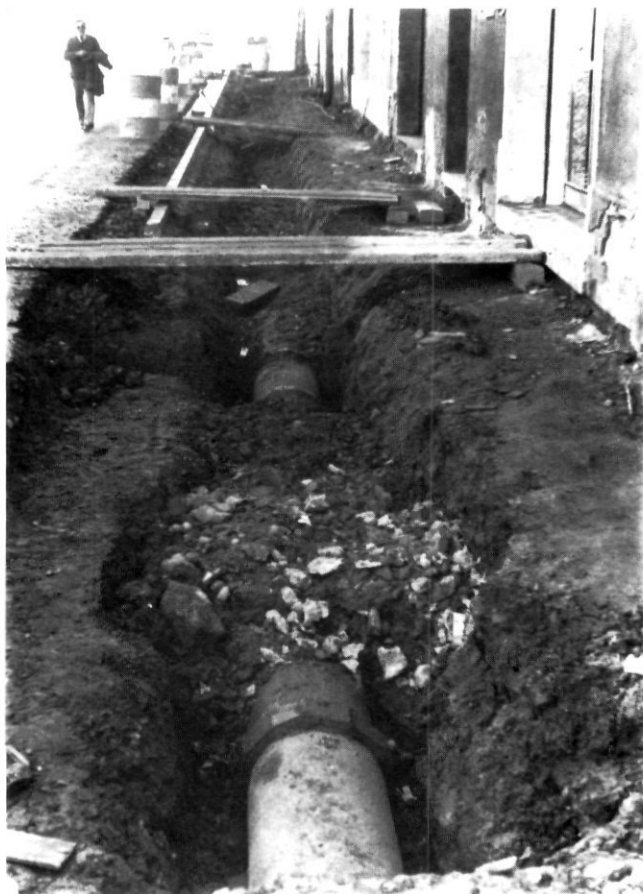
Vista parcial de les obres d'arranjament de les voreres, que s'estan efectuant a l'Avda. de J. Mestres.
