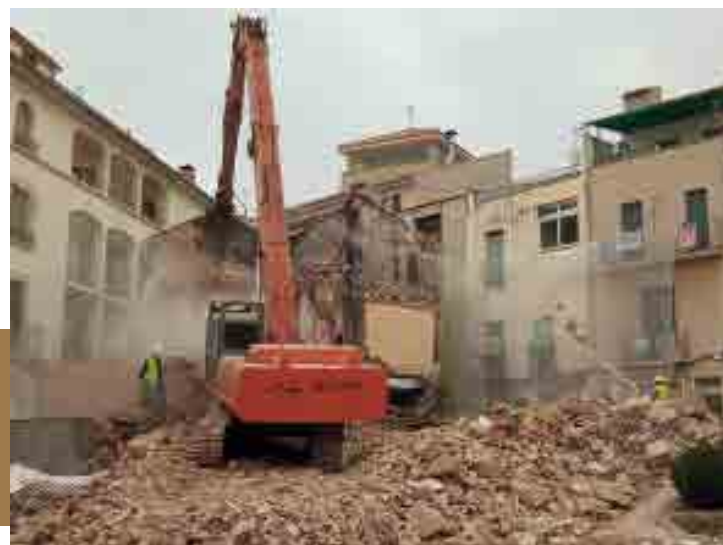
L'enderroc de les cases s'ha fet amb una pinça hidràulica de demolició. Els treballs s'han realitzat amb molta cura.
