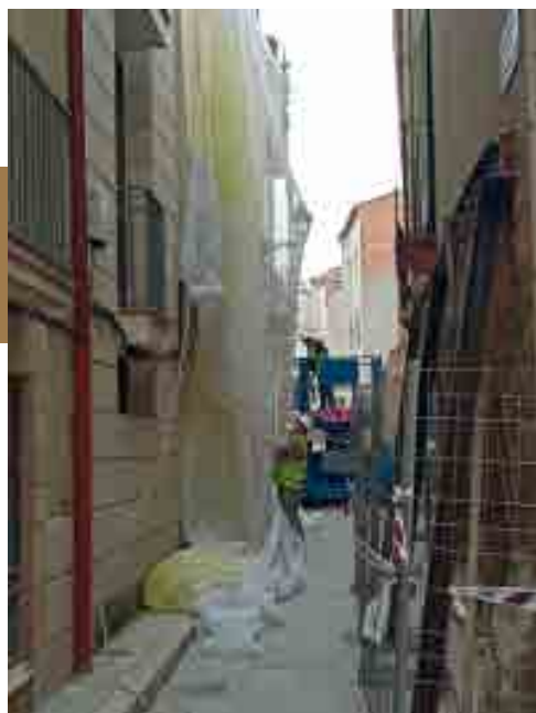
Treballadors protegint les façanes de les cases del davant amb una xarxa.
