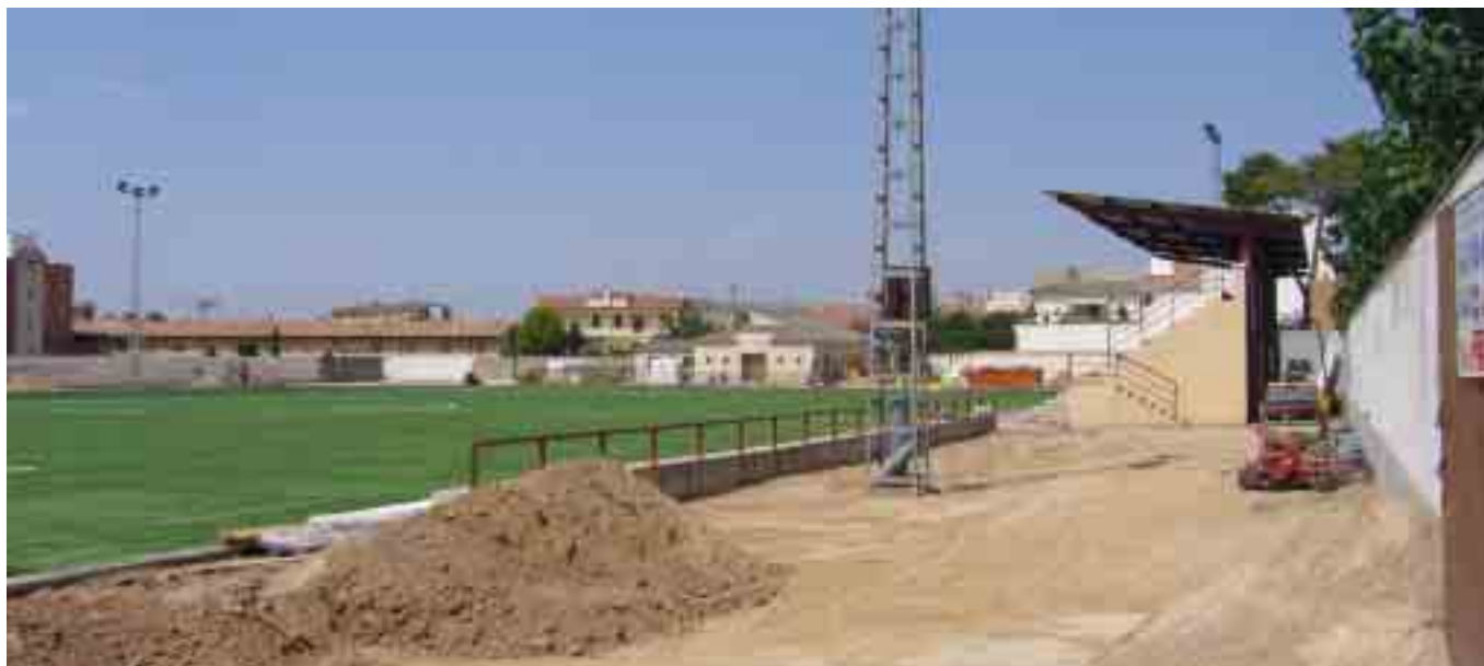
A dalt a la dreta i a baix, obres de quan es va posar la gespa artificial. Va ser la remodelació més important feta al camp d'ençà de la seva construcció.
