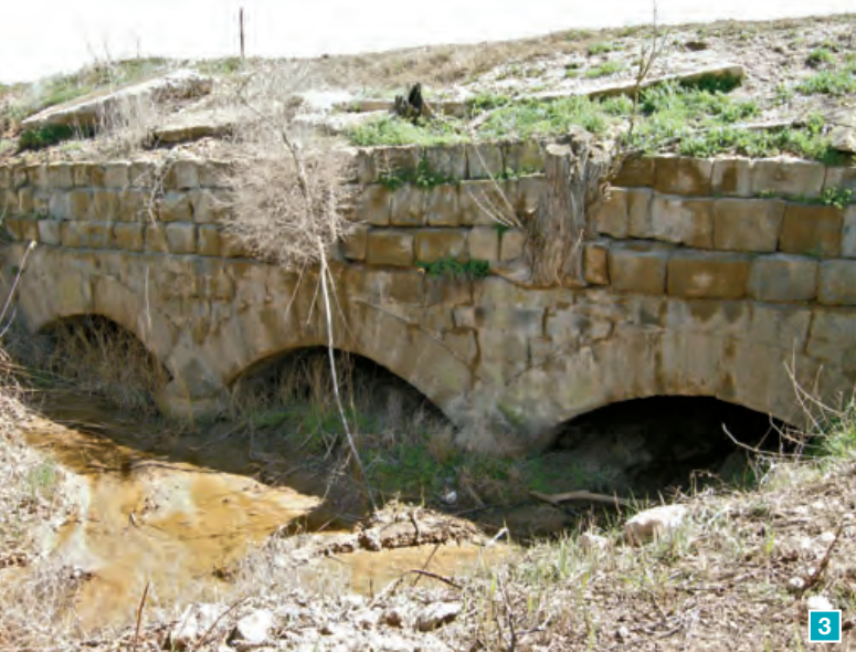
Els Tres Pontets que serveixen perquè el Reguer Salat passi per sota del canal d'Urgell. Aviat va quedar tapat i l'aigua saltà per sobre.
