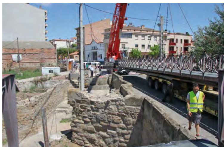
Per retirar els dos trams del pont es va necessitar una grua molt potent i un camió de gran tonatge.
