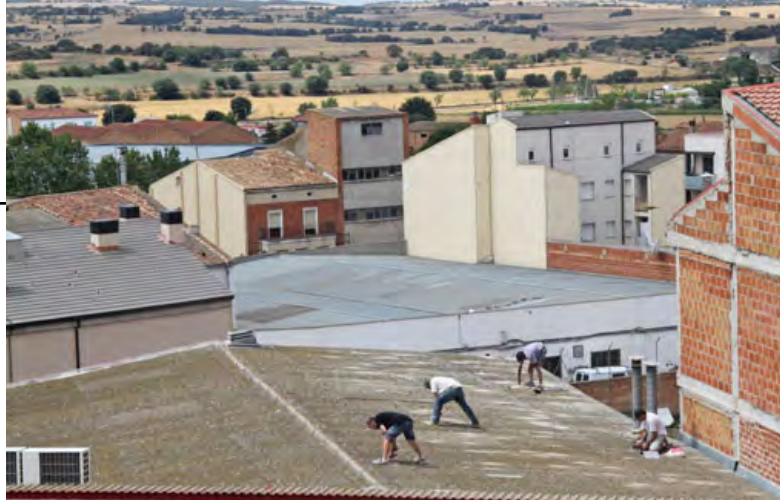
L'impacte de les pedres afecta tot tipus de teulades. Ràpidament es va acudir a fer uns treballs d'urgència.
