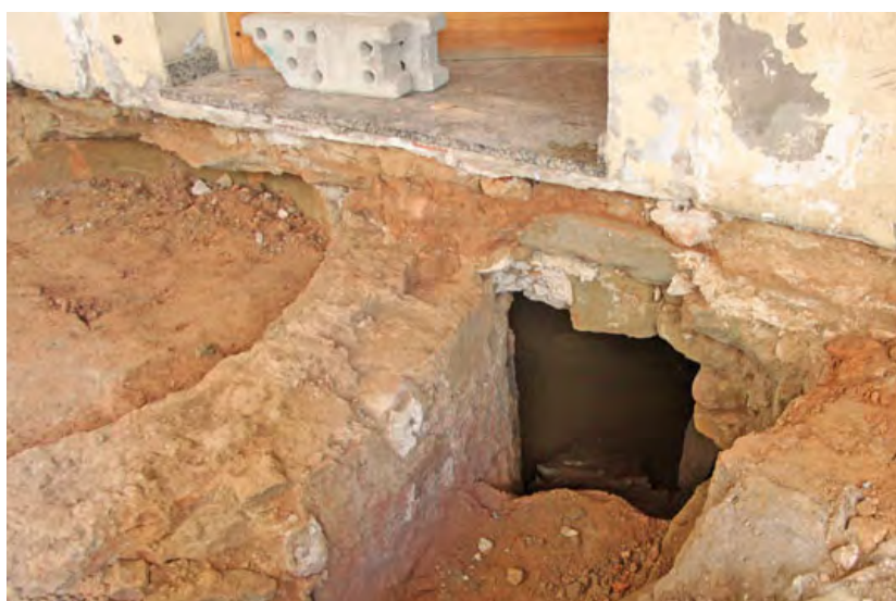
El subsòl de la zona està completament foradat.
