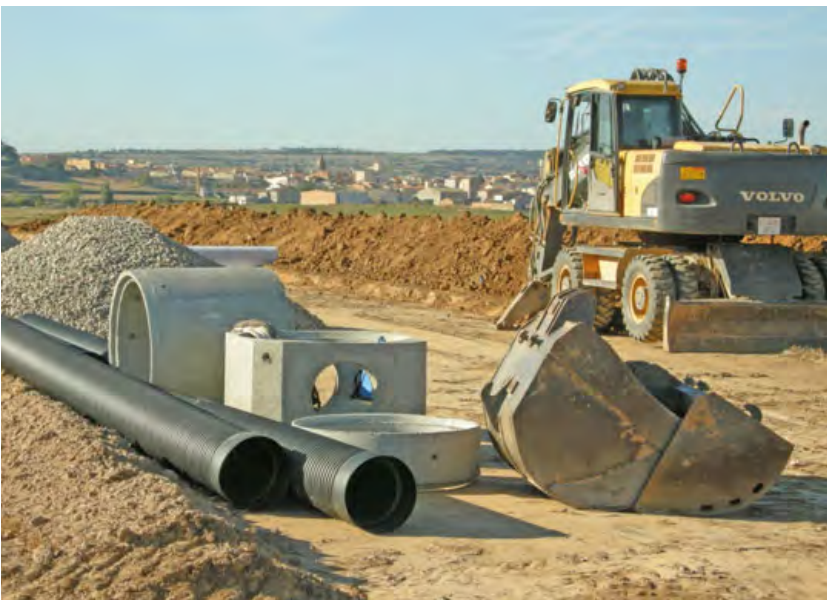
Paral·lelament a la construcció dels nous camins s'anaven obrint rases per instal·lar les canonades de reg i desguàs.
