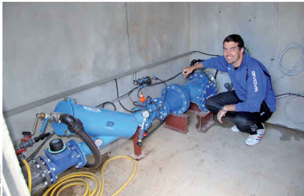
Interior de la caseta on hi ha els sistemes de filtratge i injecció d'adob líquid, entre altres.
