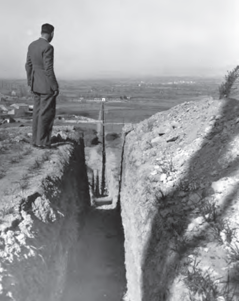
Regions Devastades renova el servei d'aigua potable. A la foto la rasa de la nova canonada des de l'estació de bombeig del canal fins als dipòsits del Convent.
