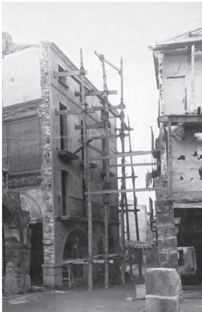
Edifici en construcció al costat de cal Siscar. Observeu que les bastides es feien amb bigues i taulons de fusta subjectades amb cordes.
