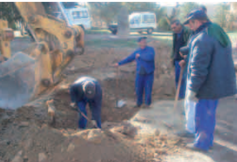
Treballs de localització de la cisterna. A la dreta, canal d'entrada d'aigua procedent de les teulades del convent.
