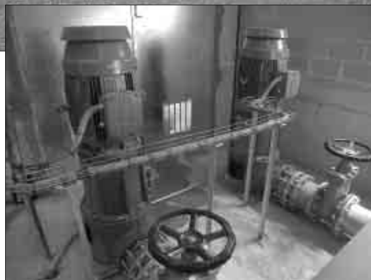
L'equipament disposa de dues bombes d'impulsió d'aigua.
