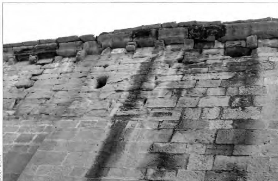
Detall del ràfec i les mènsules (algunes ja han perdut la imatge). També el mur pateix de l'aigua de la pluja en haver-hi el ràfec en mal estat.
