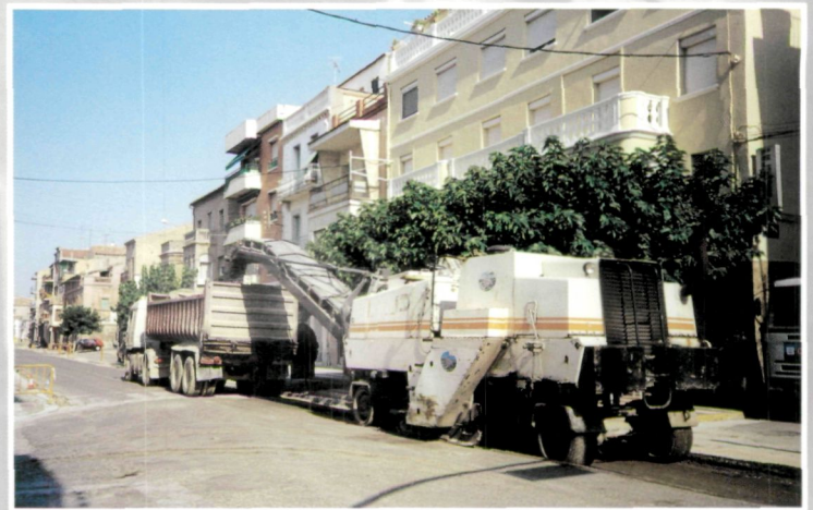
Una potent màquina alçava el quitrà vell de la carretera i, ella mateixa, el carregava a un camió.
