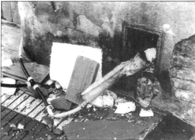
Una instal·lació provisional per a proveir-se d'aigua.
