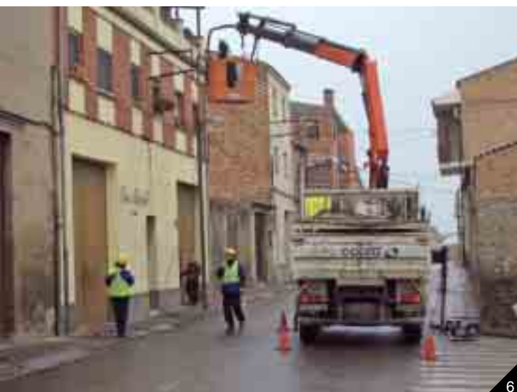
A baix, operaris d'Endesa en el moment de canviar el cablejat elèctric.
